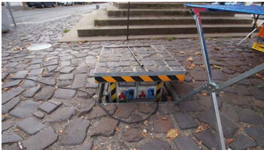
Obrázek č. 29 Staroměstské náměstí v Mladé Boleslavi: připojení na zdroj elektrické energie
